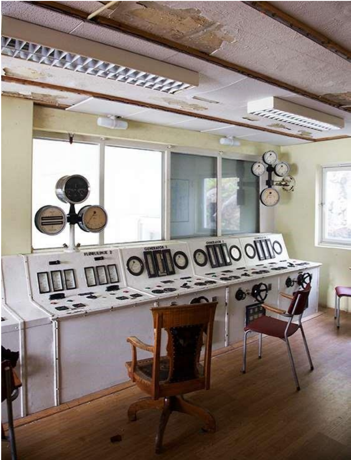
Det er relativt nytt å sjå på industrien som kulturminne. Ideen oppsto først på 1980-talet og er ei følge av at industri ikkje lenger berre hørte framtida til, men også fortida. Bildet er frå kontrollrommet i Flørli kraftstasjon.
