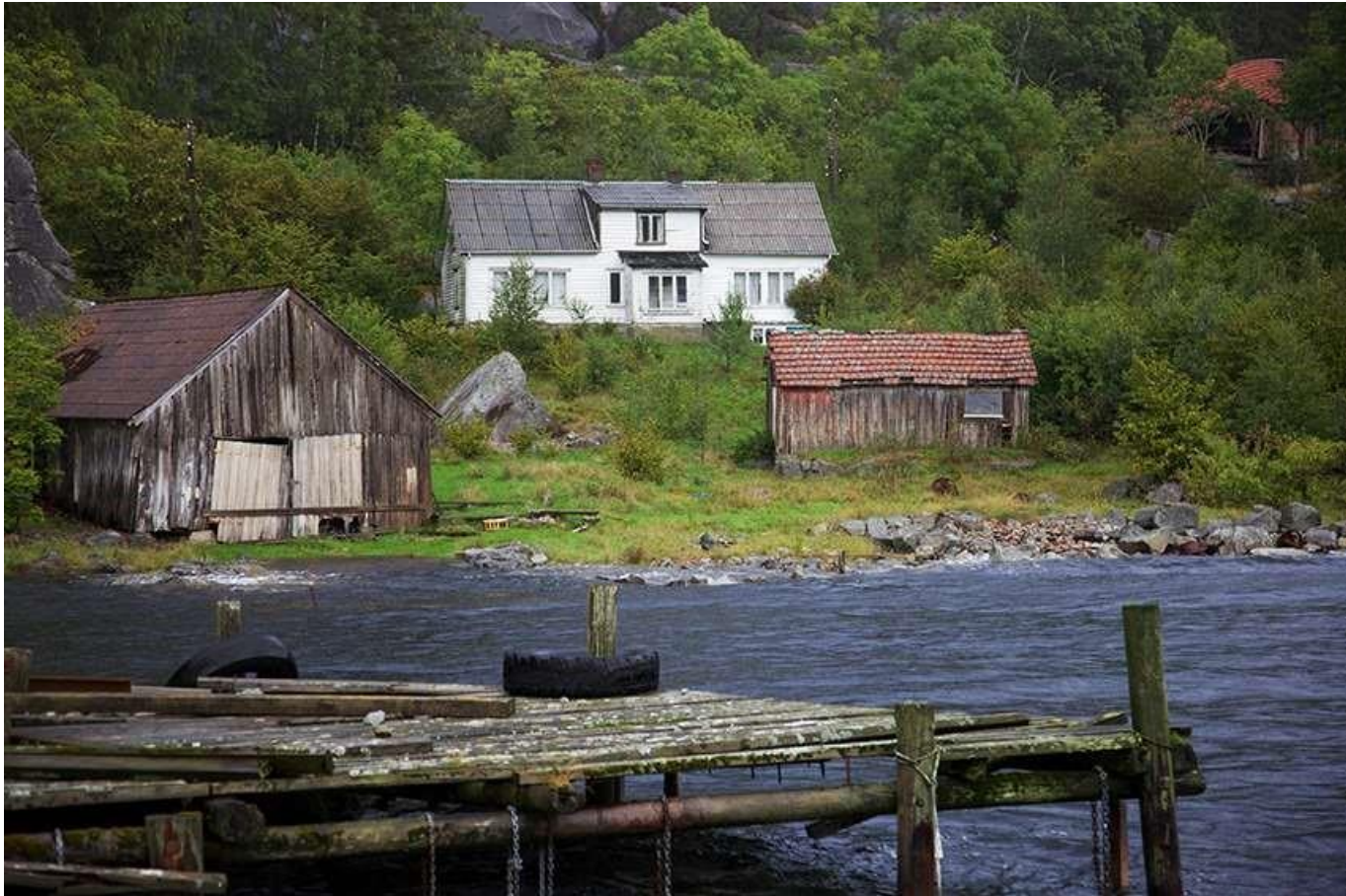
Kallastein ser framleis ut som ein kjekk plass sett frå sjøen, men ved nærmare ettersyn viser det seg at tilstanden er i ferd med å bli kritisk dårleg.
